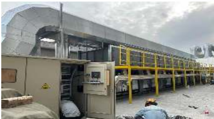
大型设备喷涂企业 12万风量催化燃烧项目
